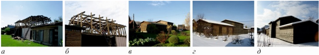
Рис. 16. Дача А.А. Чернова: а, б — строительство верхнего яруса; в–д — общий вид дома
