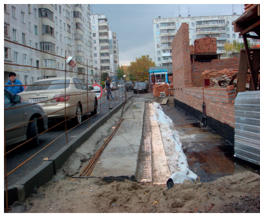
Рис. 2. Дорога с парковкой над подвалом, кладка кирпичных стен 1-го этажа, сентябрь 2010 г.
